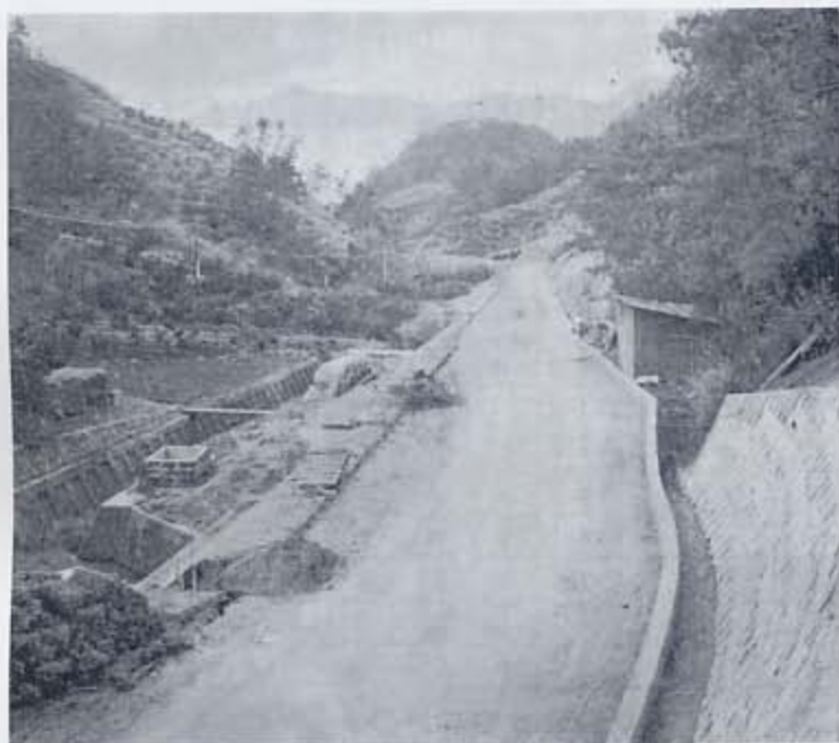
◀ 1971（昭和46）年頃の、県道立花池田線道路工事の様子。写真は幸峠から立花を望む。
